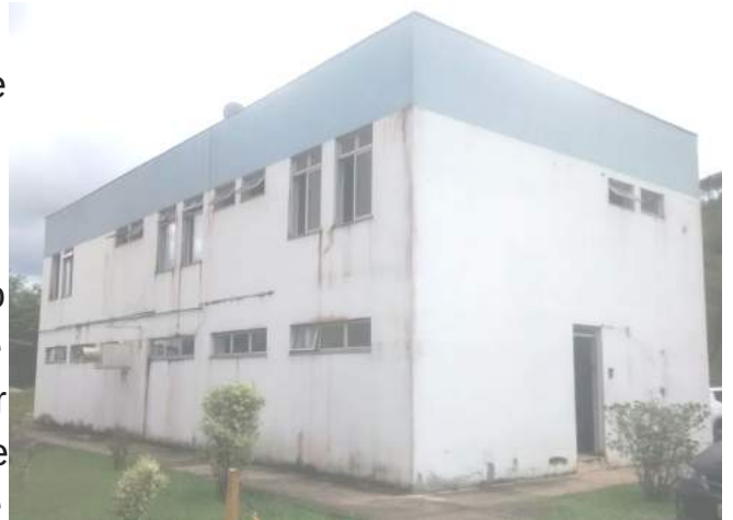
Prédio antes ocupado pelo SAMU em reforma para moradia de médicos residentes.
